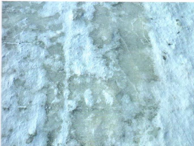
Фото 8. Сетка мелких нераскрывшихся трещин на армированном участке
