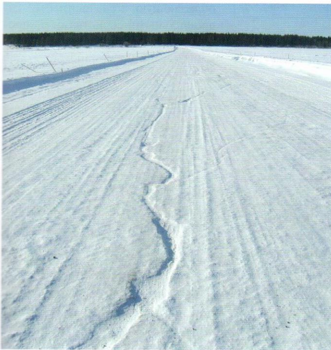
Фото 7. Температурные трещины на неармированном участке
