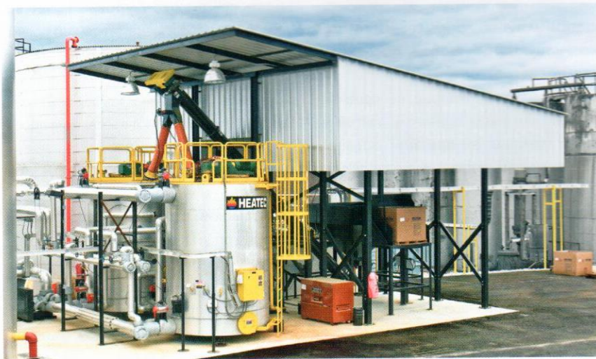
Завод компании Heatec для производства ПБВ
